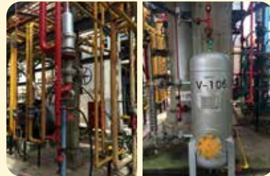
(氫氣排至廢氣總管)
