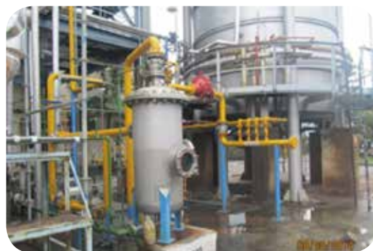
廢氣回收入加熱爐
